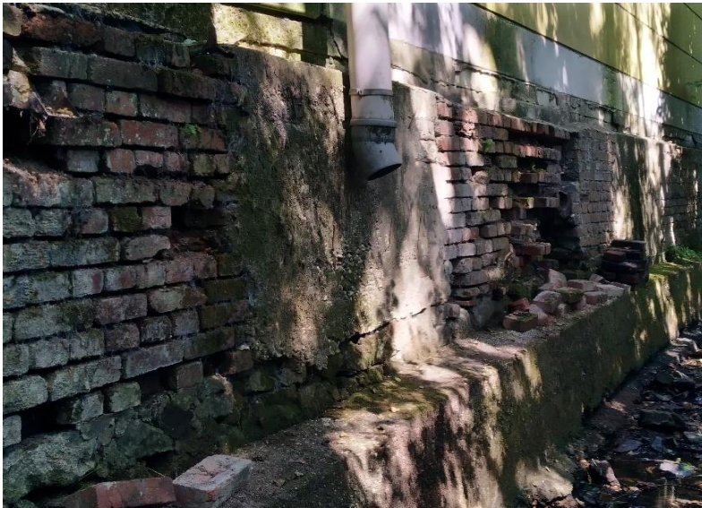
Schäden Ufermauer Mirker Bach
